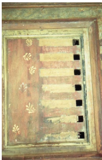
Figura 48. Estado da placa de registos antes do restauro. Fonte: AOEO.
