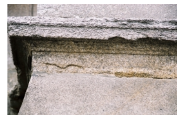
Fig. 7 - Sé do Porto. Pormenor do remate superior da base do par de colunas do lado direito. Zonas de pedra diferente e surgimento de erosão agravada.
