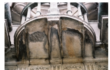
Fig. 10 - Sé do Porto. Vista inferior do varandim que remata o portal. Ocorrência de manchas, possivelmente crostas negras.
