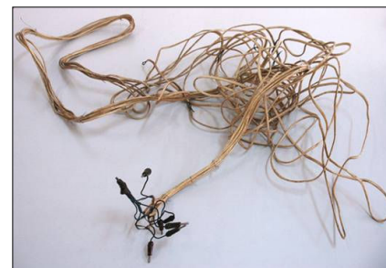
Fig. 7- Elementos constituintes da instalação: cabos eléctricos
